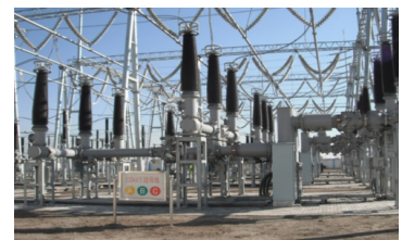
252kV HGIS xinjiang fianbei substation
