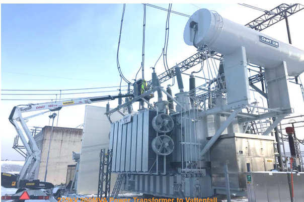
225kV 200MVA ,Power Transformer to Vattenfall
