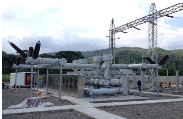
145kV GIS - Honduras
