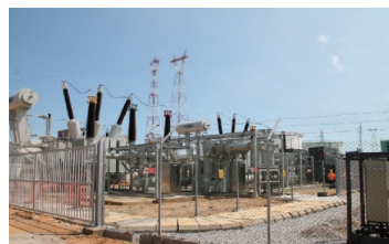
252kV GIS AGGREKO UK Cote d'Ivoire project
